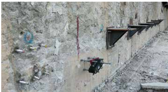
Установка опорных столиков для монтажа распорной системы ограждения котлована (Павелецкая площадь, г. Москва, 2018 г.)
